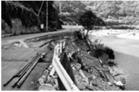
市道玉川落合線の崩落現場
