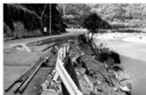
市道玉川落合線の崩落現場
