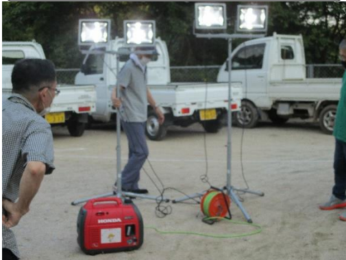
（発電機、投光器×2）
