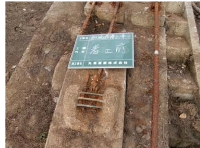
ため池における 老朽化したゲート
