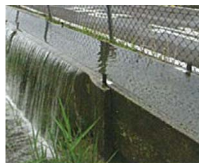
水路からの溢水
