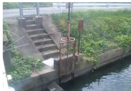
老朽化したゲート
