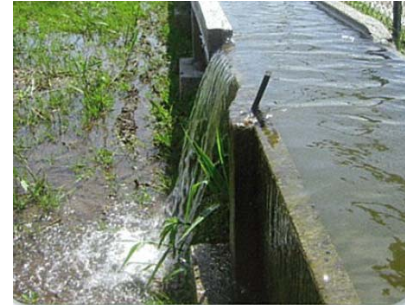
水路からの部分的な溢水
