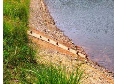
老朽化した取水施設
