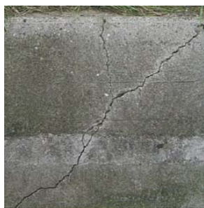
斜め方向のひび割れ
