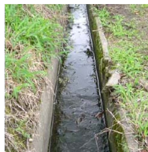
部分的な欠損
