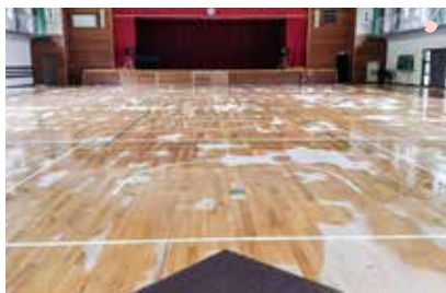
被災した体育館
