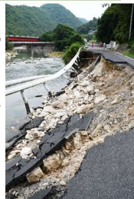
平成30年7月豪雨災害により大きな被害を受けた市道
