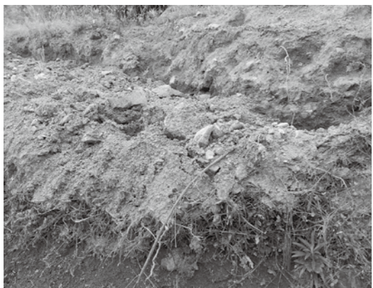
インシシに掘り返されたのり面
