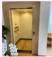
エレベーター
