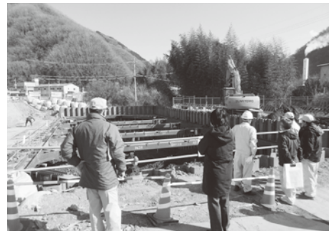
落合雨水ポンプ場
