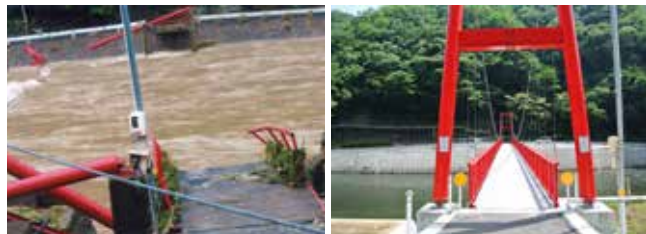
災害時（左）と復旧後（右）の用瀬橋（備中町志藤用瀬地内）
