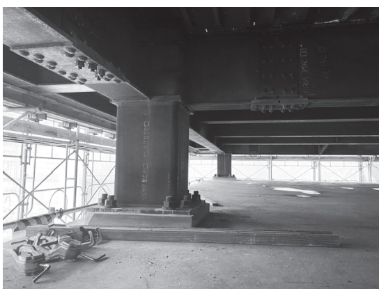
新消防庁舎1階と2階間の 防火区画
