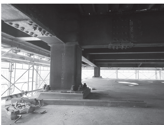
新消防庁舎1階と2階間の 防火区画
