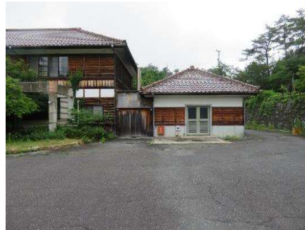
外観（ボイラー室）
