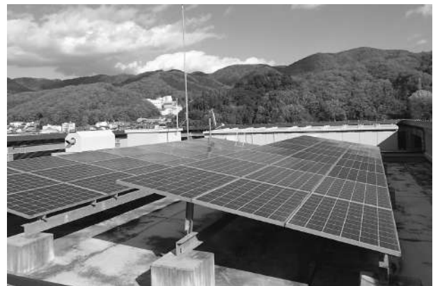
太陽光パネル
