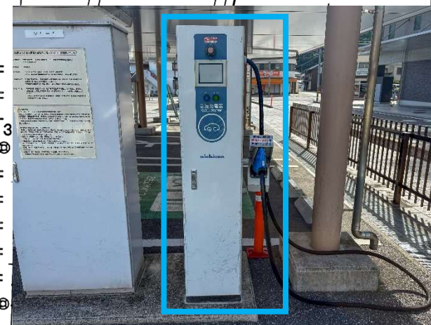
既設EV急速充電設備
