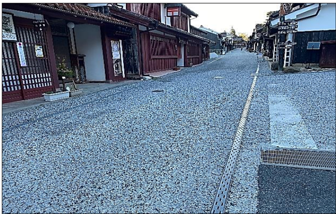
路面の傷みが進んでいる市道吹屋線
