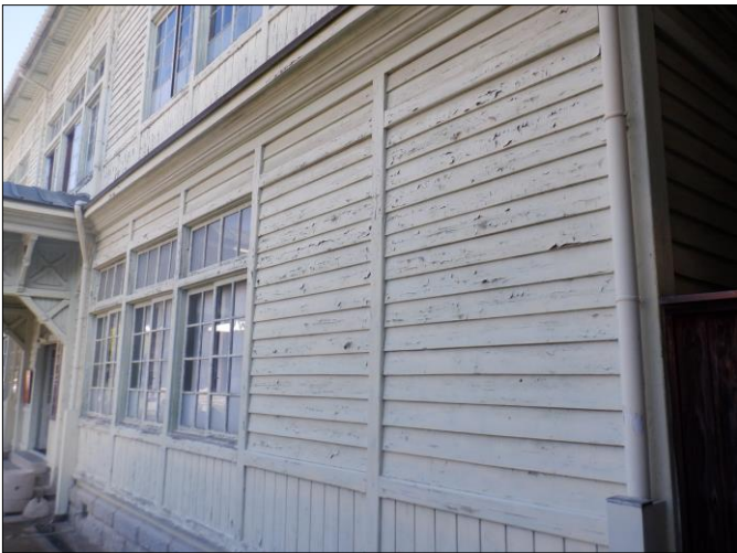
外壁のペンキ剥離
