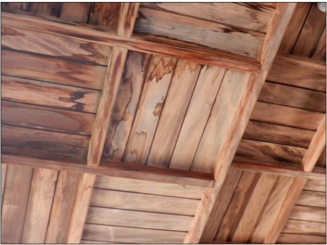
雨漏りの痕跡(2階講堂の天井)
