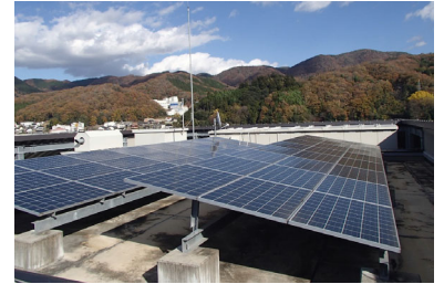
太陽光発電設備（本庁舎）
