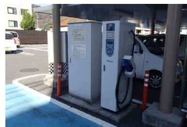
急速充電器（本庁舎）
